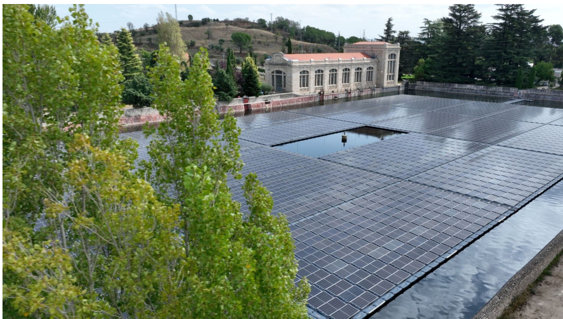
El Canal de Isabel II suma nueve plantas fotovoltaicas y aumenta hasta el 86% su capacidad de autosuficiencia energética
